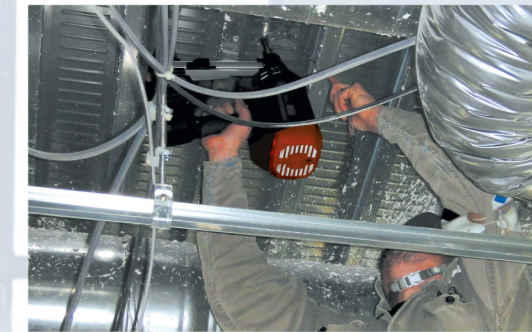
Paturi pentru cabluri
